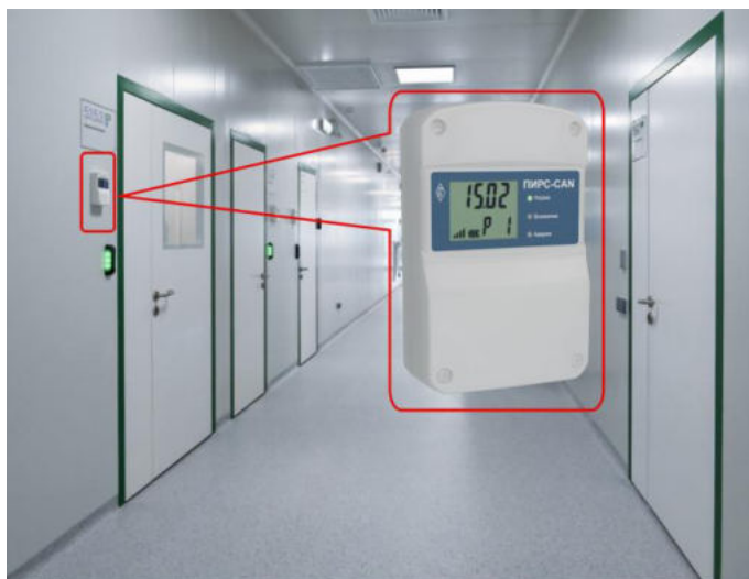
Узел «ПИРС-CAN» с подключенным к нему датчиком ИПМ-41-03-1-1 , установленный в коридоре
