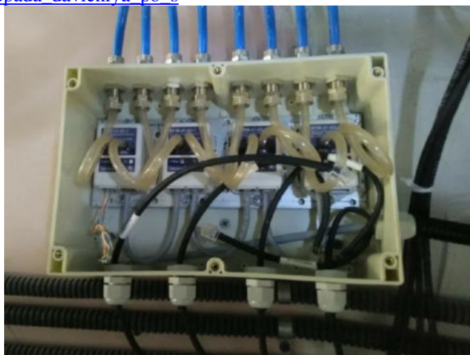
Датчики ИПМ-41-03-1-1 , установленные в пылезащитный бокс, который размещён в запотолочном пространстве.
